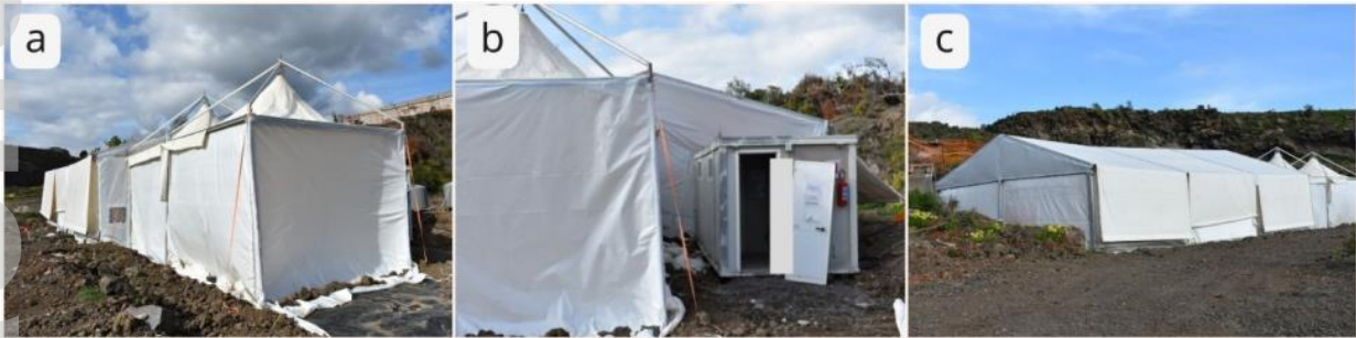
Figure 10 a, b, c - Confinamento in tendostruttura in depressione con UDP per la demolizione di edifici
