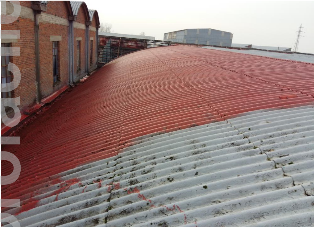
Figura 2. Coperture in cemento-amianto parzialmente incapsulate
