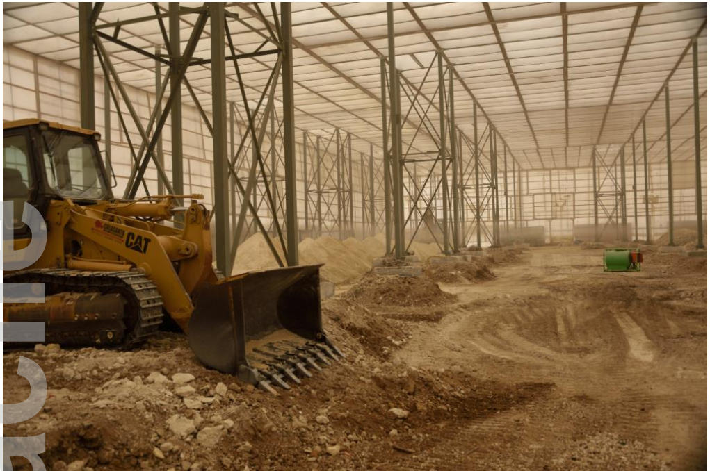
Figura 12. Bonifica di suoli contaminati da amianto eseguita in confinamento statico-dinamico di grandi dimensioni
